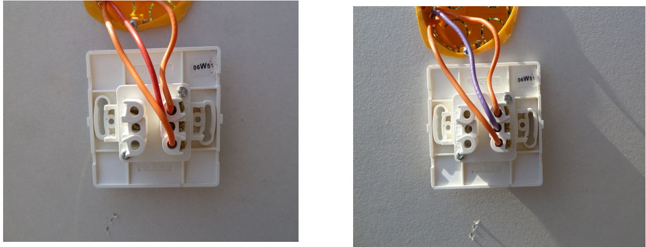
Figure 13 : traces des connexions attendues et réalisées du va-et-vient (appareillage Vega , face arrière de l'objet)
